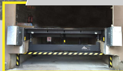
Équipements de quai
